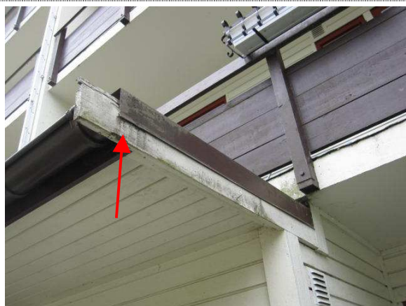
Bilde nr. 33 - Takene over inngangspartiene har behov for vedlikehold. Blant annet råtne i på dekkbordene.
