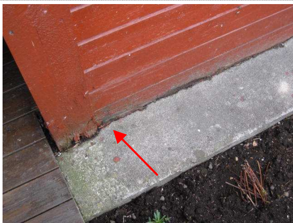
Bilde nr. 27 - Kledningen går helt ned til bakken. Dette fører til at fukt suges opp i panelet. Dette er en uheldig løsning, som bør endres på.
