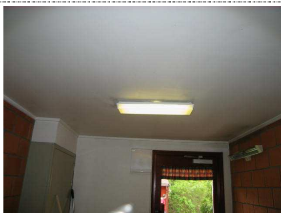
Bilde nr. 2 - Det er nyere lysarmaturer i trappegangene.
