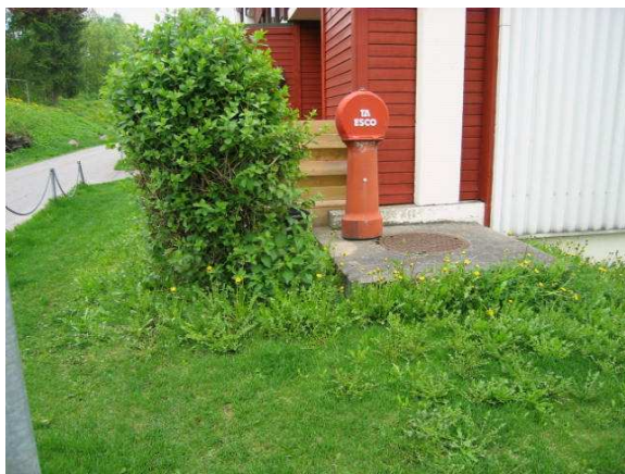
Bilde nr. 13 - Utvendig brannhydrant.
