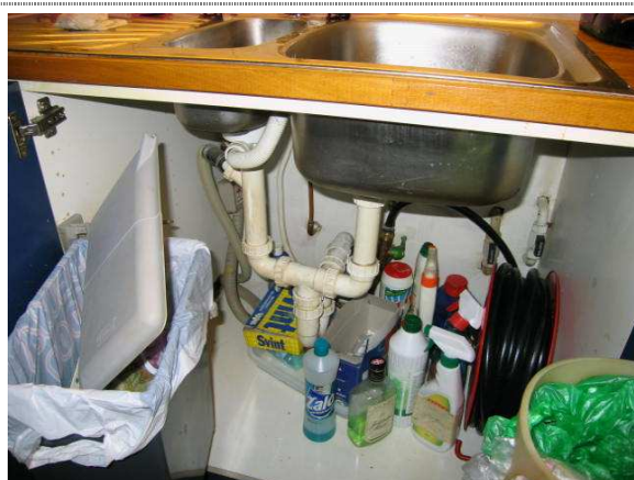
Bilde nr. 3 - Leilighetene har husbrannslange i kjøkkenskap.
