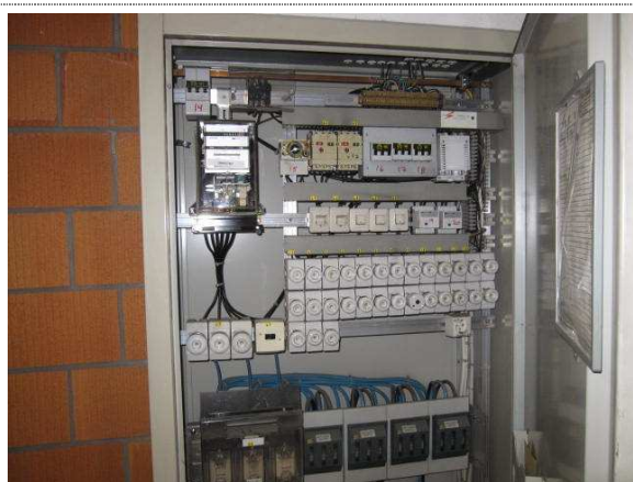
Bilde nr. 5 - Hovedtavlene er fra byggeåret 1983/1984.
