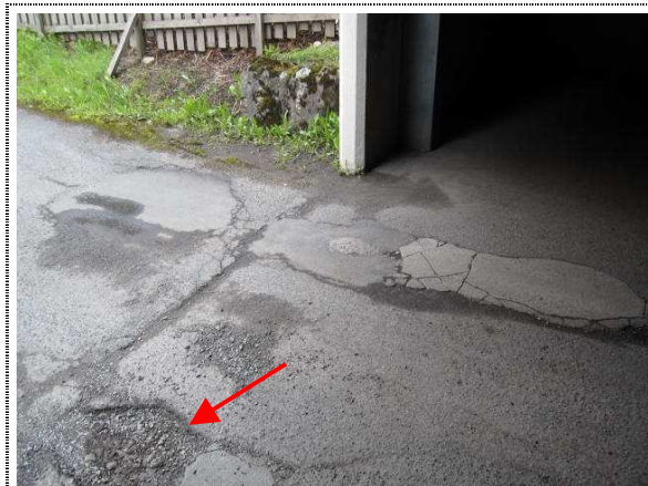
Bilde nr. 44 - Asfalten er flere steder noe dårlig.
