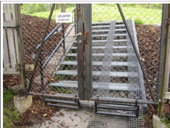
Bilde nr. 43 - Vedlikehold av port er nødvendig.
