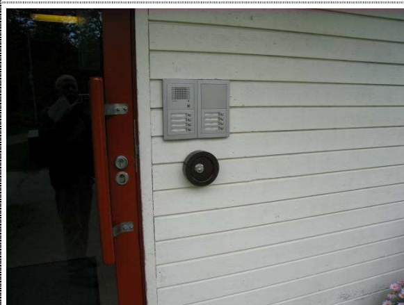
Bilde nr. 11 - Porttelefonanlegg fungerer tilfredsstillende.
