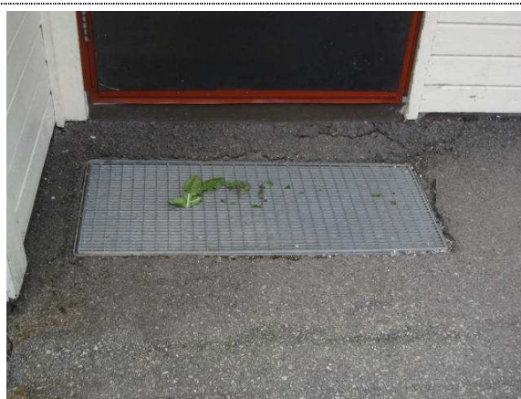
Bilde nr. 32 - Inngangspartiet til flere oppganger synker. Dette bør utbedres.
