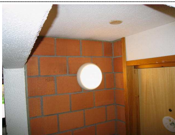
Bilde nr. 10 - Kompaktlysarmaturer av nyere dato i oppgangene.
