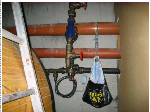
Bilde nr. 16 - Reduksjonsventil, vannmåler og avløpsrør i plast.
