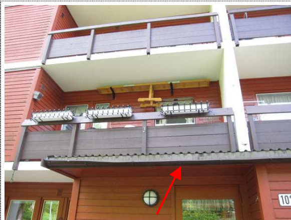
Bilde nr. 41 - Takrenner i dårlig stand.
