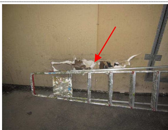
Bilde nr. 38 - Veggene til bodene i garasjen er dårlig vedlikeholdt. Utbedres.
