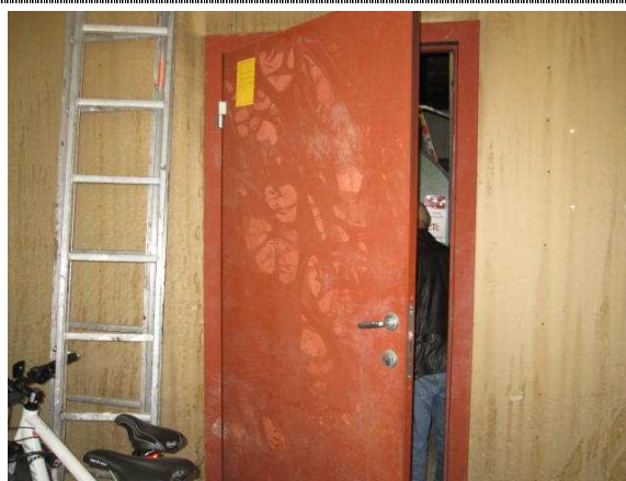
Bilde nr. 40 - Ståldør er dårlig vedlikeholdt. Slipes og males.
