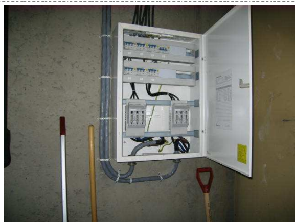
Bilde nr. 19 - Fordelingskap for nytt berederanlegg.
