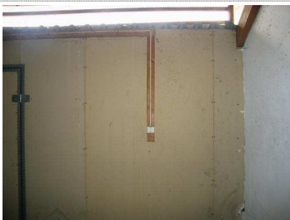
Bilde nr. 17 - Motorvarmeuttak i garasjen.
