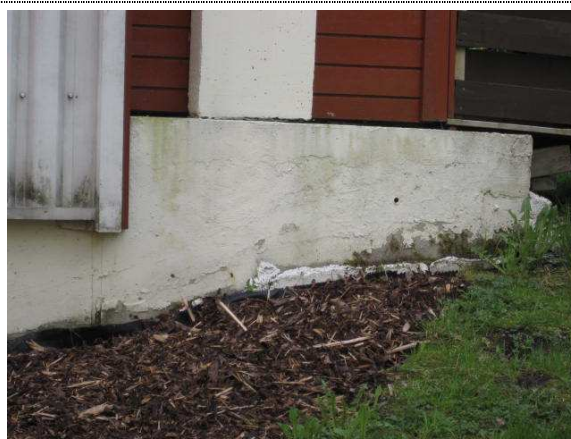
Bilde nr. 42 - Grunnmur er ikke vedlikeholdt tilfredsstillende.
