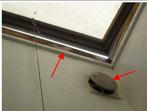
Bilde nr. 24 - Lukene har et sterkt behov for maling, da de fremstår i dårlig vedlikeholdt stand. Ventiler bør også rengjøres.
