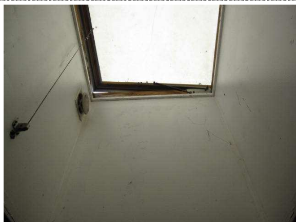
Bilde nr. 23 - Manuell røykluke i alle trappeoppgangene. Malte vegger har merker og må vedlikeholdes.
