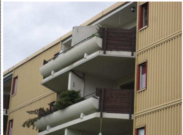
Bilde nr. 26 - Betongkontroll anbefales, da det er flere synlige armeringsjern.
