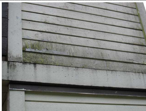
Bilde nr. 34 - Boligblokkene har behov for maling.
