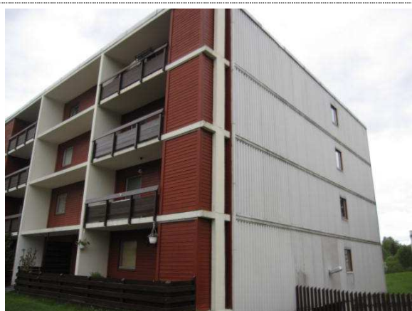
Bilde nr. 31 - Gavlveggene består av korrugerte stålplater. De fremstår noe skittne og bør rengjøres.
