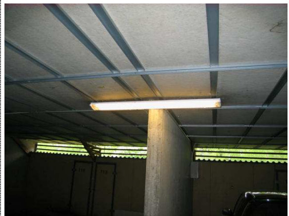
Bilde nr. 14 - Garasjeanlegget har nyere belysning.
